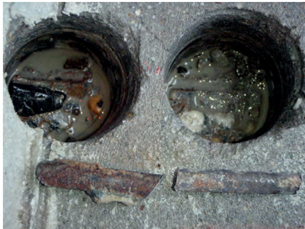
Figuur 3-5 Destructief onderzoek corrosie wapeningsstaal.
